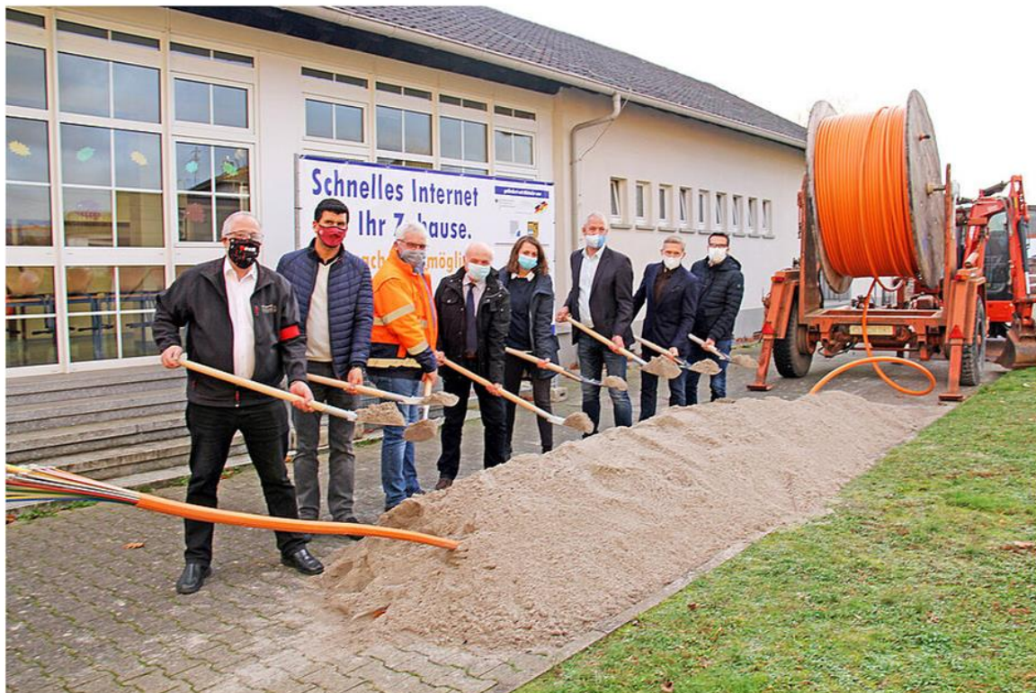
Beim Spatenstich vor der Grundschule Spesbach (v. l.): Reinhard Schneider, Geschäftsführer Stadtwerke Ramstein-Miesenbach, Landtagsabgeordneter Daniel Schäffner, Manfred Hartmüller vom Bauunternehmen Karl Müller, Albert Schädler vom Breitband-Kompetenzzentrum RLP, Teresa Klug, atene KOM GmbH, Bürgermeister Ralf Hechler, Landrat Ralf Leßmeister und Landtagsabgeordneter und Beigeordneter Marcus Klein (Foto: Stefan Layes, Quelle: www.kaiserslautern-kreis.de ).
